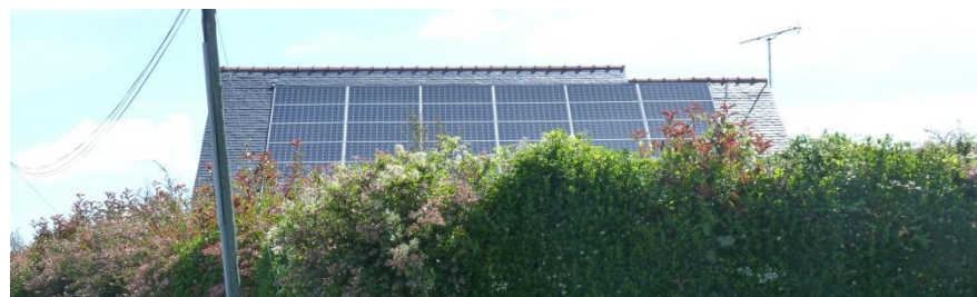
Figure 69 : Installation photovoltaïque sur toiture à Cuon (source : EVEN Conseil).
