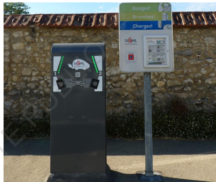
Figure 60 : Borne de recharge pour véhicules électriques à Noyant (source : EVEN Conseil).
